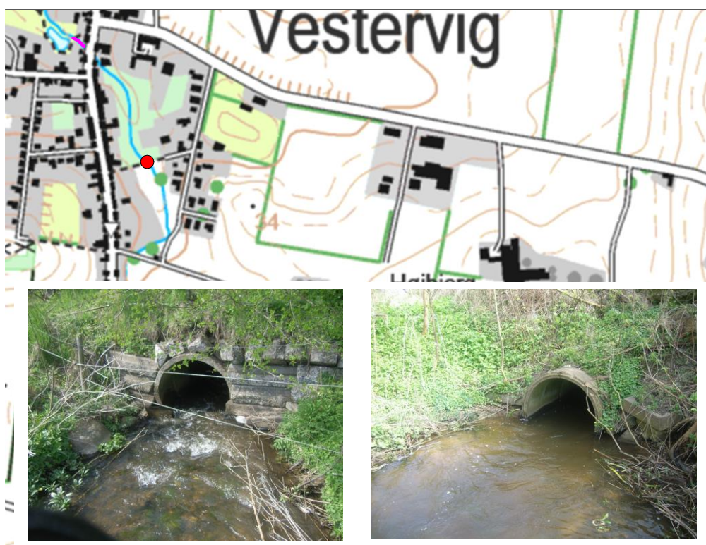
Figur 1.1: Spærring AAL-1200. Underføring under Enighedsvej. Kraftigt fald ved indløb.
